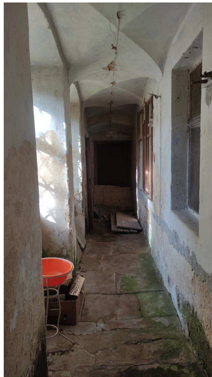
Obr. 28. Pohled do místnosti 08 (chodba). Viditelné poškození vzlínající vlhkostí a biologickým napadením v spodních úrovních zdí.
