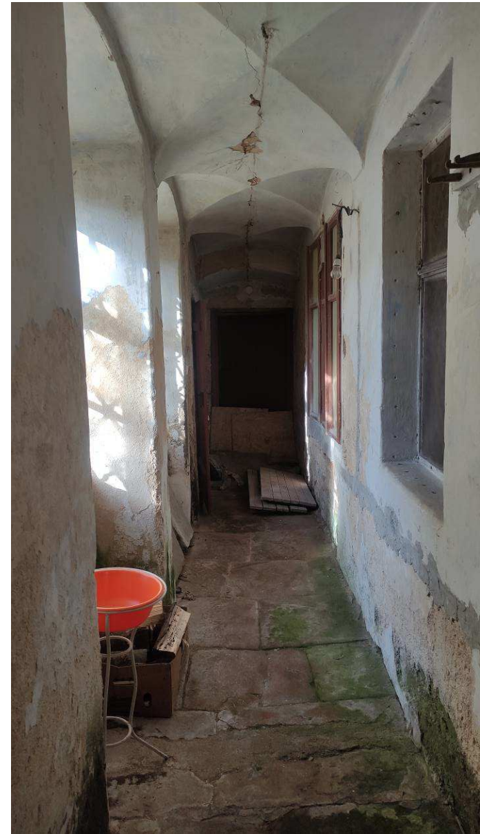
Abb. 28: Ansicht in den Raum 08 (Flur). Sichtbare Schäden durch ansteigende Feuchtigkeit und biologischen Befall in den unteren Bereichen der Wände.
